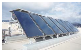
消防署西河原分署に設置した太陽熱温水器
